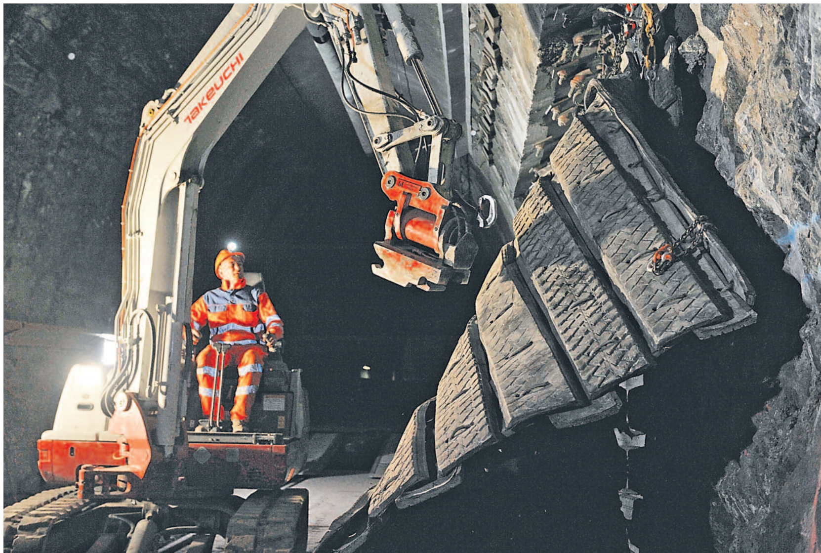
Wenig Platz. Die Kabelverbindungen der Stromversorgung müssen im Fels eingelassen werden, was jeweils eine Sprengung erforderlich macht.
